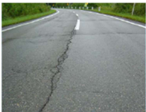
図 2 凍上量相違により発生した舗装面のクラック
