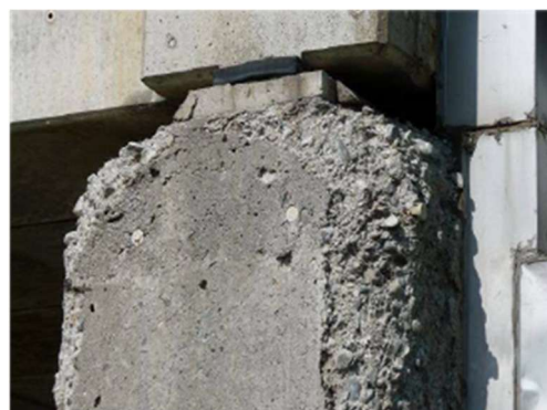
図 2 スケーリングによって表層剥離した橋台
